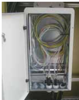
Сварной шкаф NC-320, установленный внутри уличного шкафа
