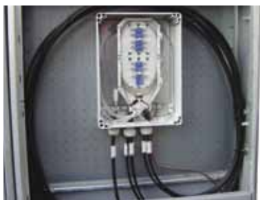
Сварной шкаф NC-300 установленный внутри уличного шкафа
